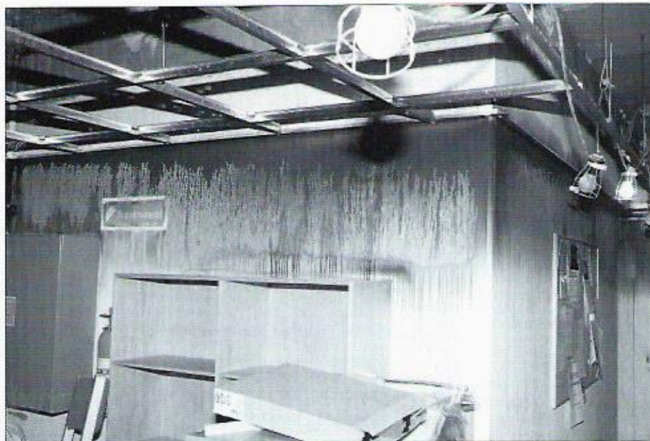
Skaden er sket. Alt er i ruiner.
